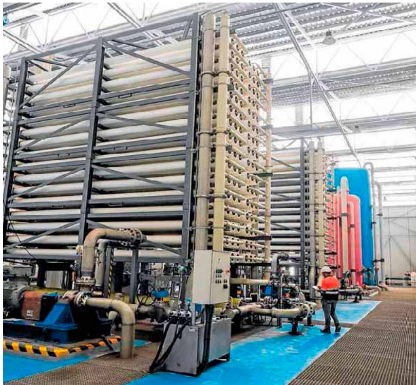
Imagen de archivo de una desaladora en pleno funcionamiento. SUR
