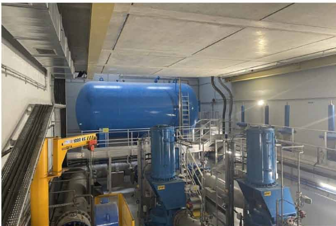
Intérieur de la nouvelle station de pompage d'Antony. (©HH/actu Paris)
