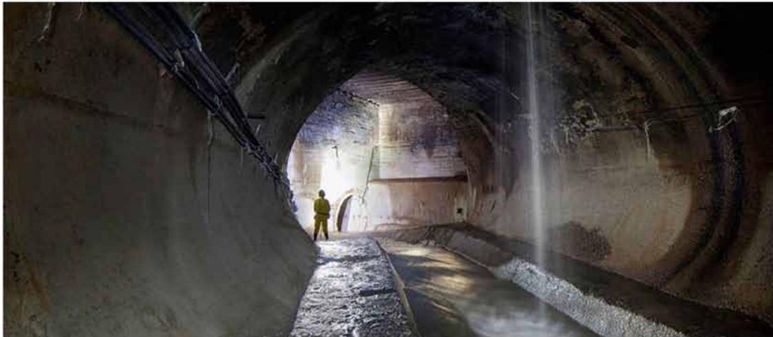
Imagen del alcantarillado de Madrid
